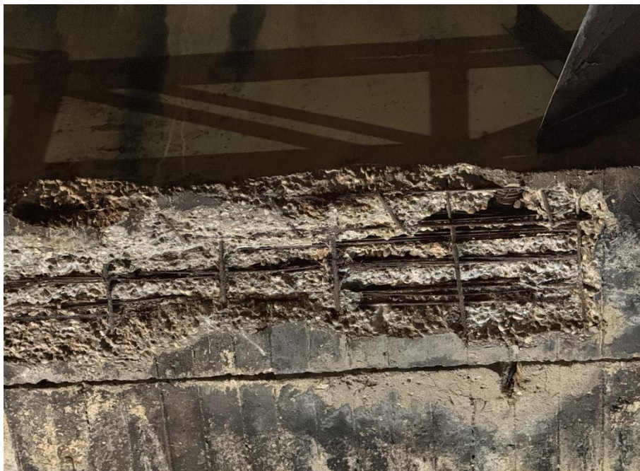
Figura nº 9: Estado del centro de vano de la viga de borde derecha. Fuente: INES Ingenieros (15/03/2025).
