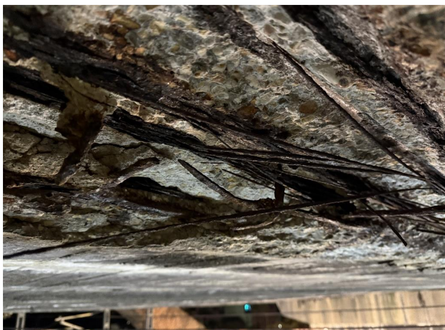
Figura nº 3: Detalle de la rotura y pérdida total de alambres (2ª viga del lado izquierdo). Fuente: INES Ingenieros (15/03/2025).
