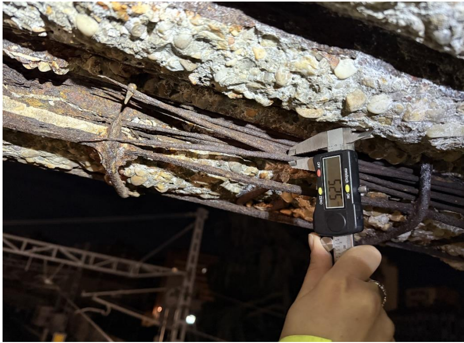
Figura nº 4: Medición del diámetro en alambres rotos (viga de borde izquierda). Fuente: INES Ingenieros (15/03/2025).
