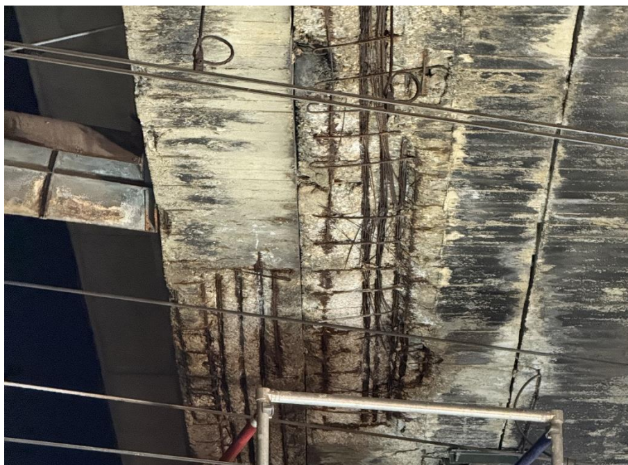
Figura nº 2: Estado general de las vigas del lado izquierdo. Fuente: INES Ingenieros (15/03/2025).
