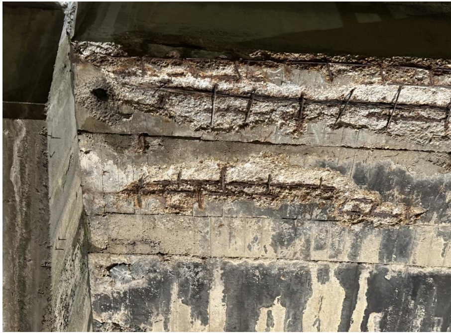
Figura nº 8: Estado del extremo sur de las vigas (lado derecho). Fuente: INES Ingenieros (15/03/2025).
