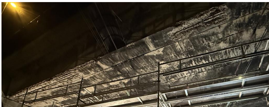
Figura nº 6: Estado general de las vigas del lado derecho. Fuente: INES Ingenieros (15/03/2025).
