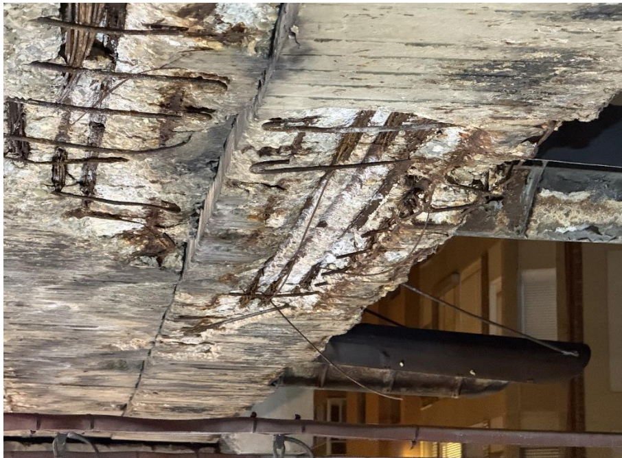
Figura nº 5: Detalle de pérdida de sección y tensión del pretensado (lado izquierdo). Fuente: INES Ingenieros (15/03/2025).
